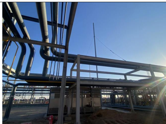
储罐区油气回收系统
