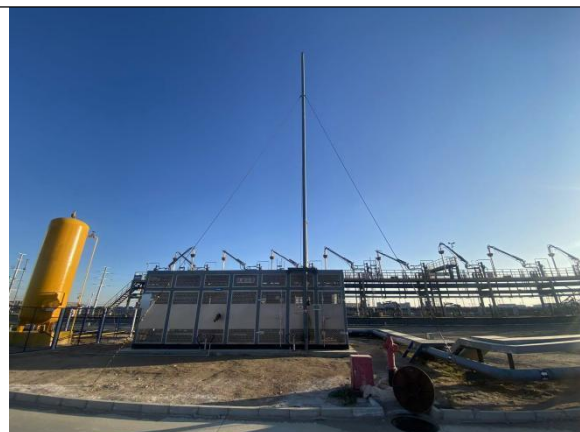
装卸栈台油气回收系统
